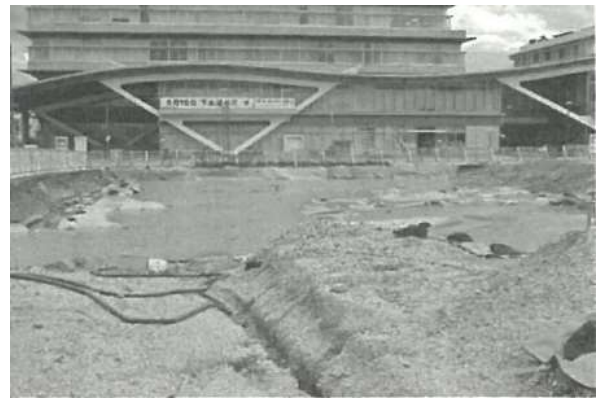
大雨による被害状況
