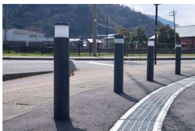
フットライト併設電源（敦賀市）
