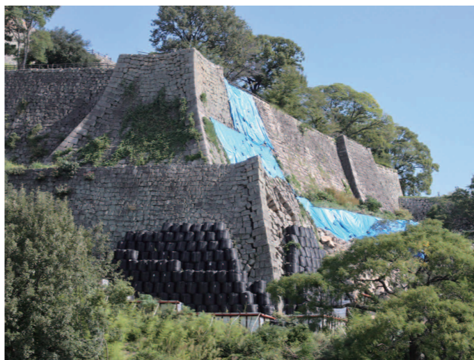
崩落直前の石垣(10月8日撮影)
