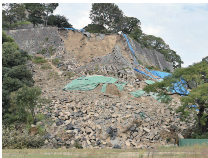
崩落後の石垣(10月16日撮影)
