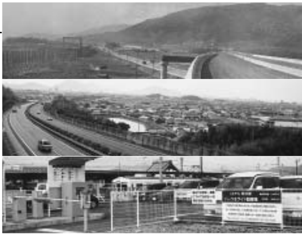
写真(上): 左は建設の進む新幹線と、右はほぼ完成した名神高速道路(昭和38年2月・京都府南部で撮影) (中): 平成4年4月に高松西~善通寺が開通した高松自動車道 (下): パークアンドライド方式を勧める「ことでん岡田駅」
