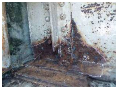
図 1.3 鋼橋の損傷例
