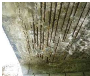
図 1.4 コンクリート橋の損傷例
