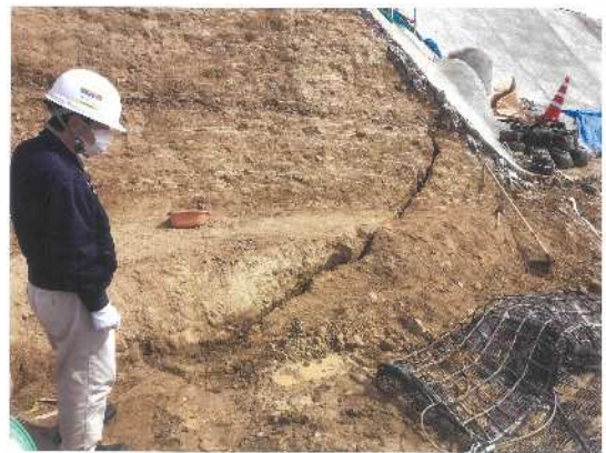
(b) 三の丸掘削時発見クラック
