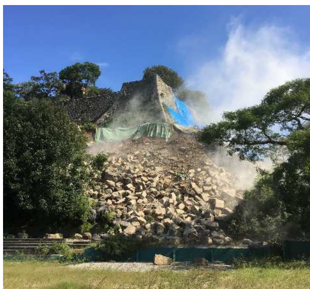
(b) 帯曲輪南西角部の崩落状況
