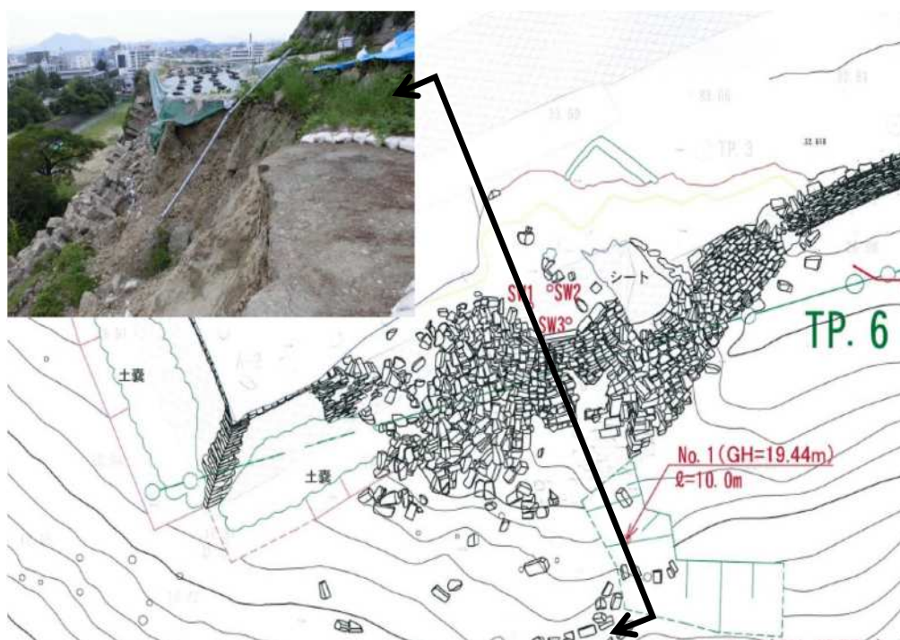
図 5-3 帯曲輪南面の崩落と断面位置図（その 2）
