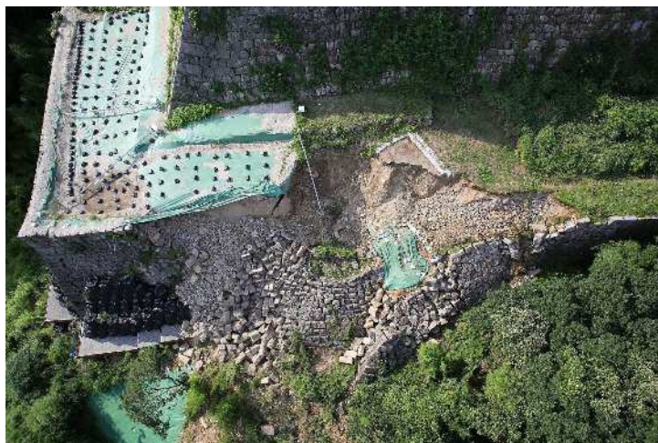
(a) 帯曲輪南面の崩落状況
