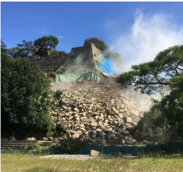
(b) 帯曲輪南西角部の崩落状況
