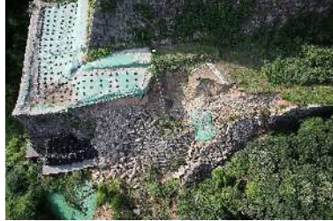
① 帯曲輪南面の崩落
