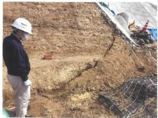
(b) 三の丸掘削時発見クラック
