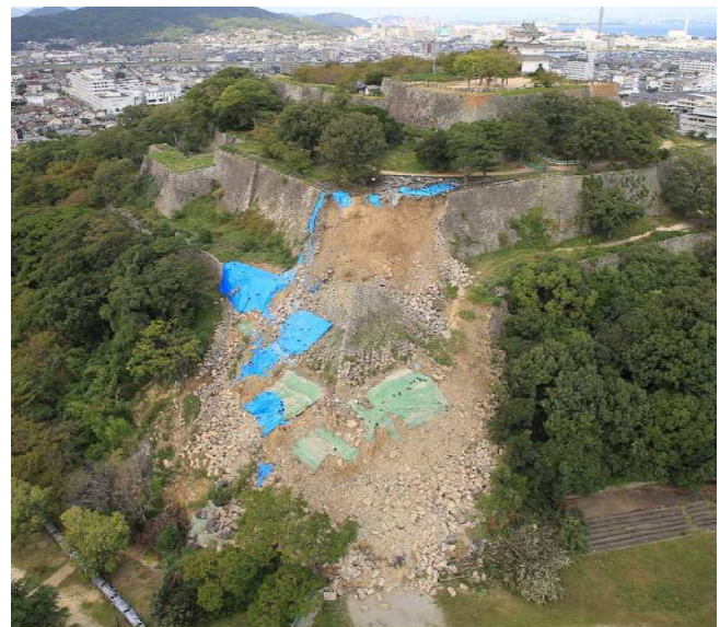
(c) 三の丸坤櫓櫓跡の崩落状況
