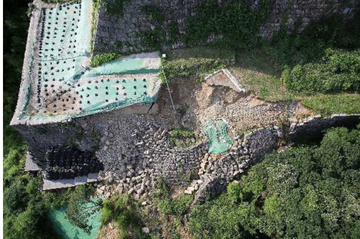
(a) 帯曲輪南面の崩落状況
