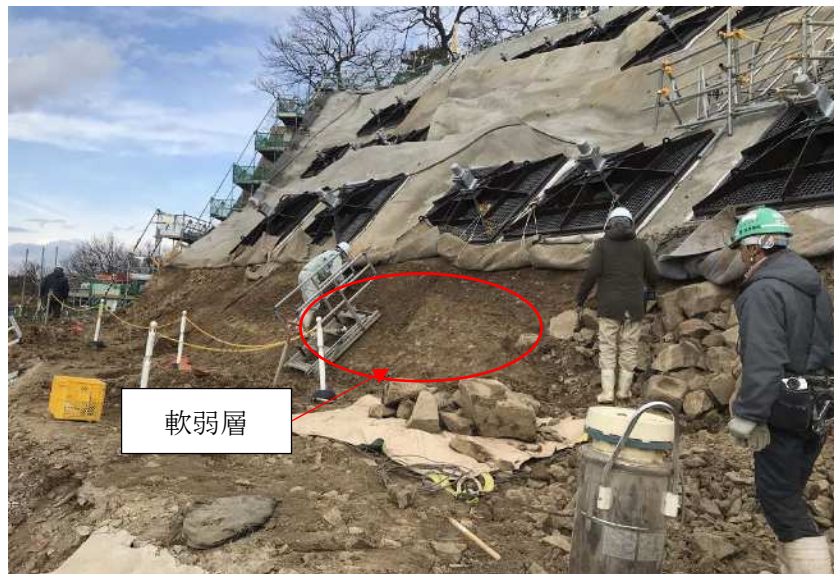
図 2-18 掘削法面上に出現した軟弱層写真（EL+36.0 付近）
