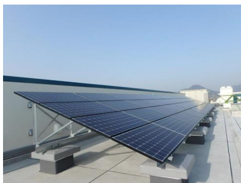
市庁舎の太陽発電システム
