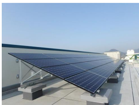
市庁舎の太陽発電システム
