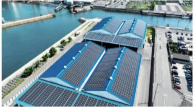
太陽光発電設備の様子
