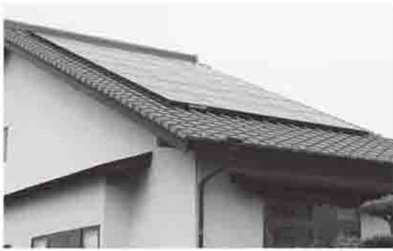
住宅用太陽光発電システム
