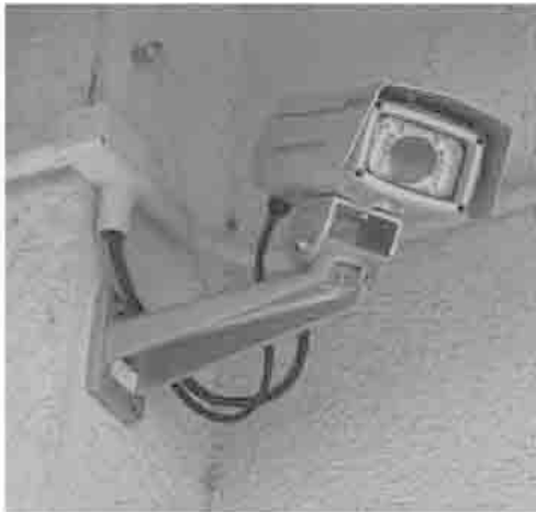
安全対策で設置した防犯カメラ
