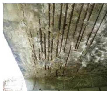
図 1.4 コンクリート橋の損傷例
