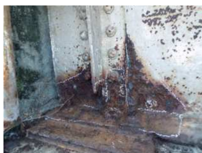
図 1.3 鋼橋の損傷例
