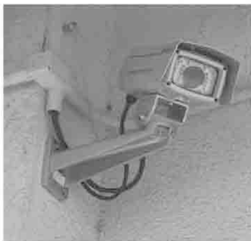
安全対策で設置した防犯カメラ
