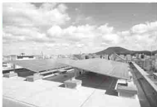
太陽光発電設備（消防庁舎）
