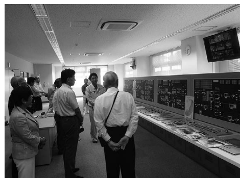
浄水場制御室
