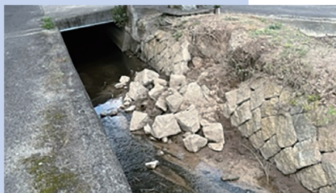
崩れたのり面 イノシシの仕業?!
