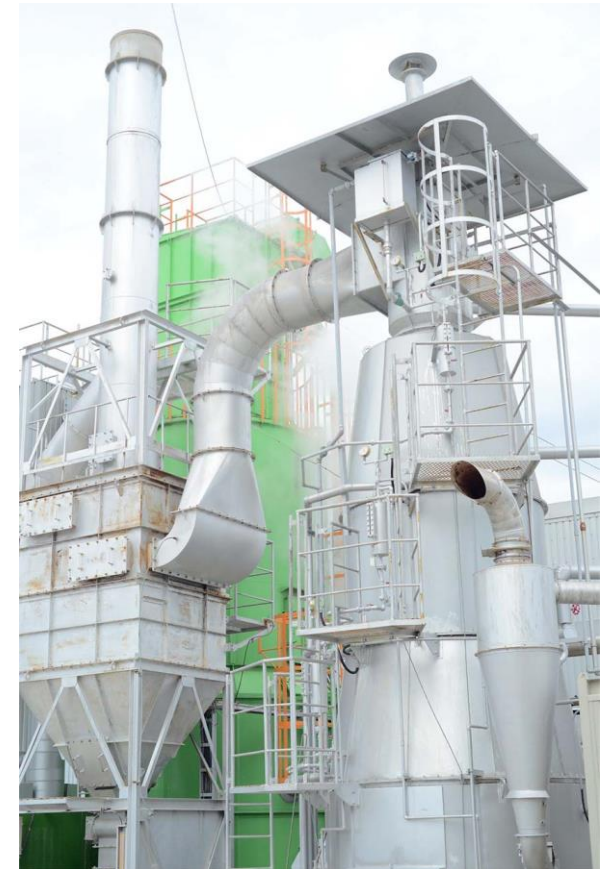
木質バイオマスボイラー
