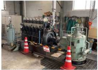
老朽化の状況
