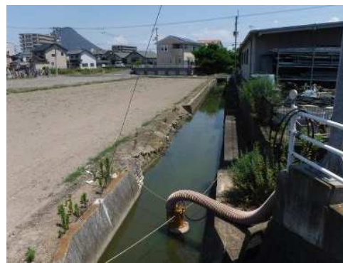
臨時排水ポンプ
