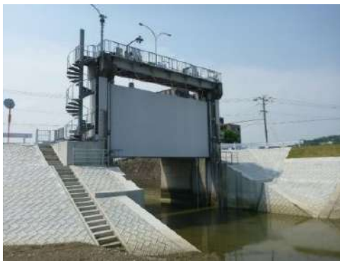
逆流防止のための水門（清水川水門）
