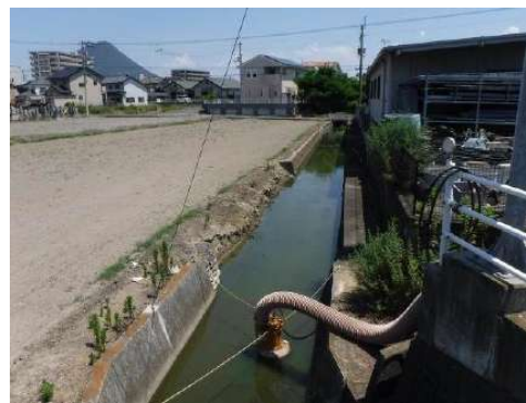
臨時排水ポンプ
