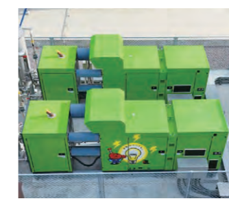
消化ガス発電機
