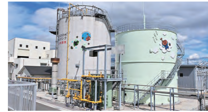
左から鋼板製消化タンク、ガスタンク
