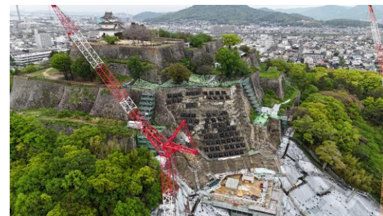
丸亀城崩落石垣の復旧
