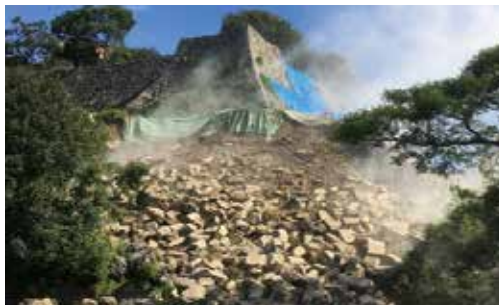
写真 83 白煙を上げ崩落した 帯曲輪南西石垣
