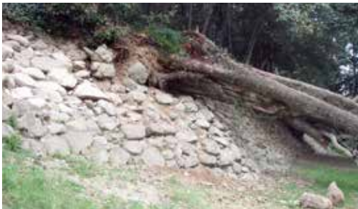
写真 67 エノキの木の倒壊による石垣の き損
