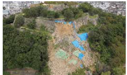
写真 84 三の丸石垣の崩落
