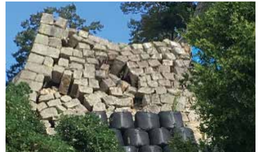
写真 82 帯曲輪南側石垣の変形
