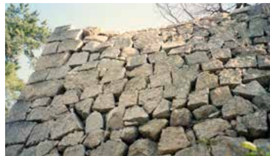
写真 59 帯曲輪西石垣の変形
