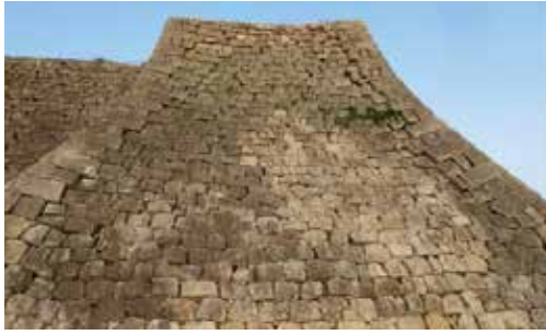
写真 77 坤櫓跡石垣の変形
