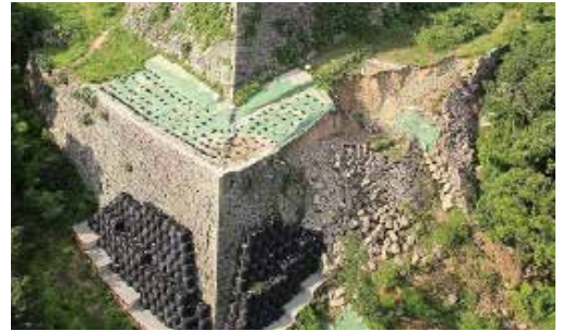
写真 80 帯曲輪南側石垣の崩落
