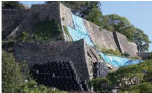
写真 81 帯曲輪南西部石垣隅角部の変形
