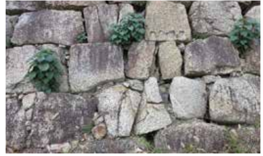
写真 78 三の丸西側石垣の石材の割れ
