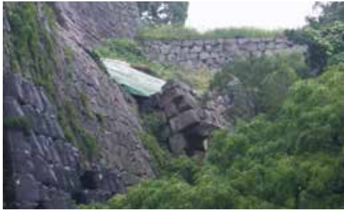
写真 79 帯曲輪南側石垣の崩落
