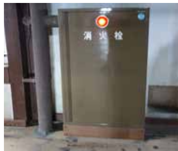
② 防火施設
