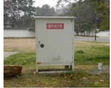
③防火施設
