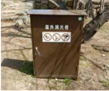
④防火施設
