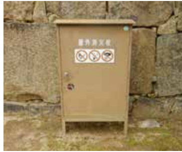
⑤防火施設
