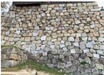
②⑧天守下の石垣 積み方が乱れている
