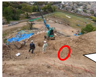
【応急対策工事中に発見されたクラック】
